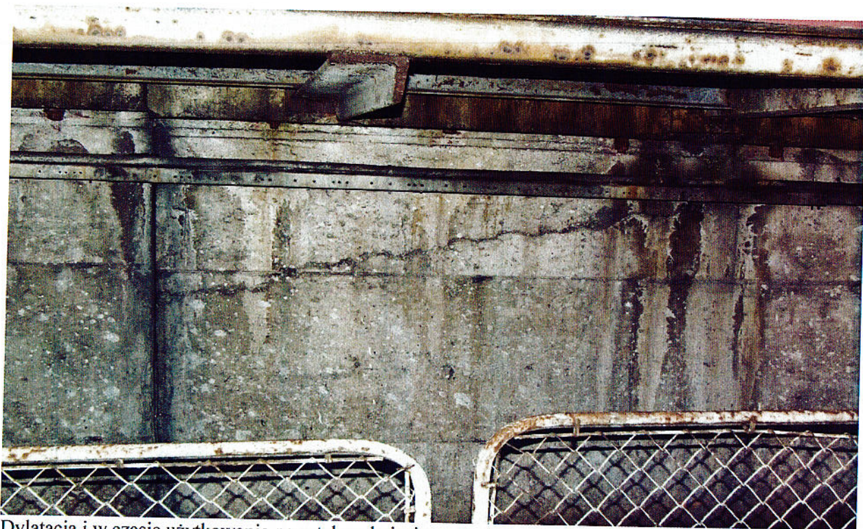
Dylatacja i w czasie użytkowania powstały pęknięcia.
